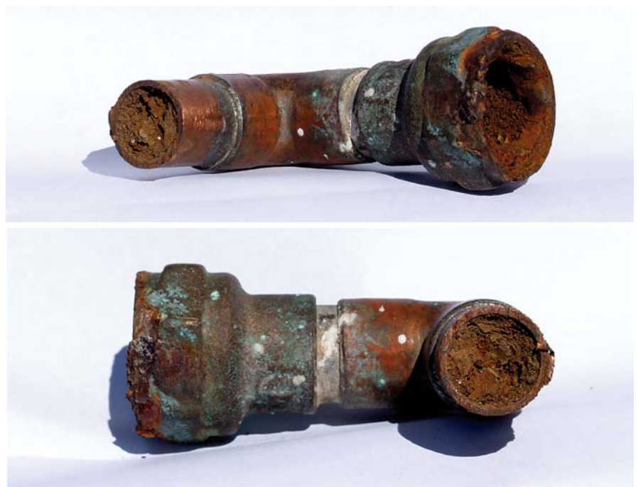
Rys. 11. Skutki zaniedbań w zakresie uzdatniania wody
